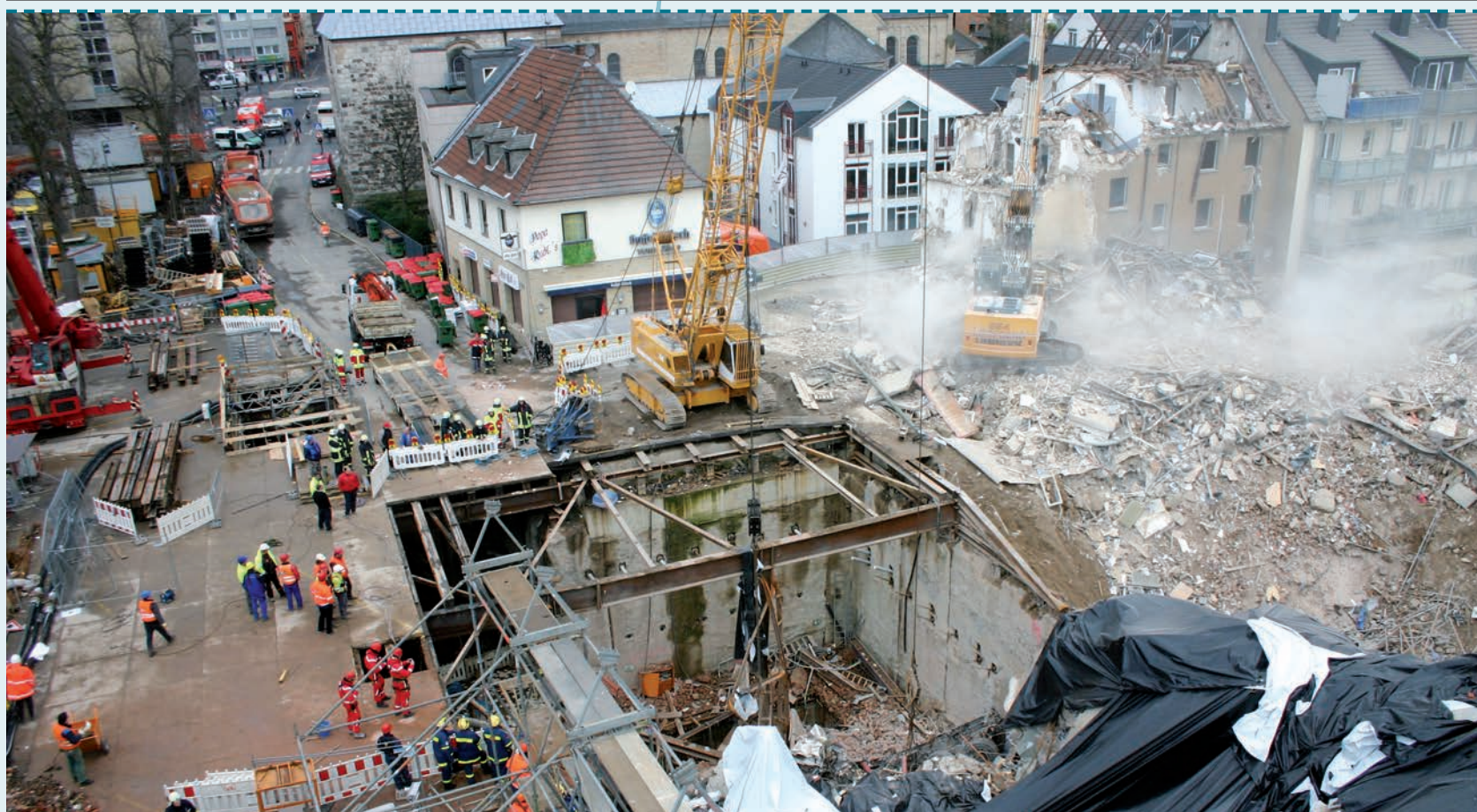
Die Einsturzstelle acht Tage nach dem Unglück. (Foto: Stadt Köln)
