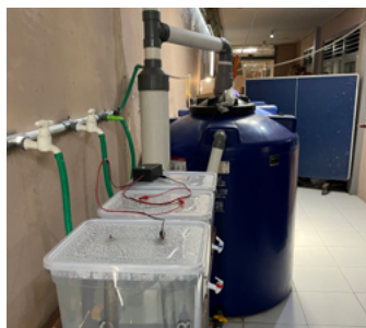
Regenwasseraufbereitungsanlage / Rainwater treatment system © Kordula Schulze
