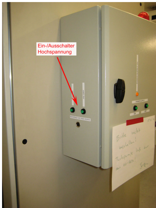
Abb. A.2: Schaltschrank links
