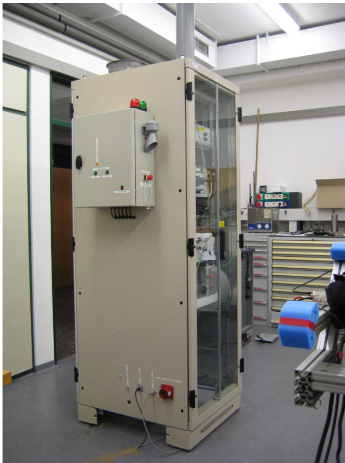
Abb. 4.34: Hochspannungsschrank für die CKrS
